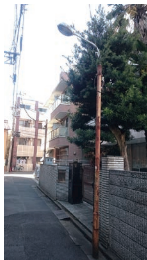
西池袋3丁目老朽街路灯
